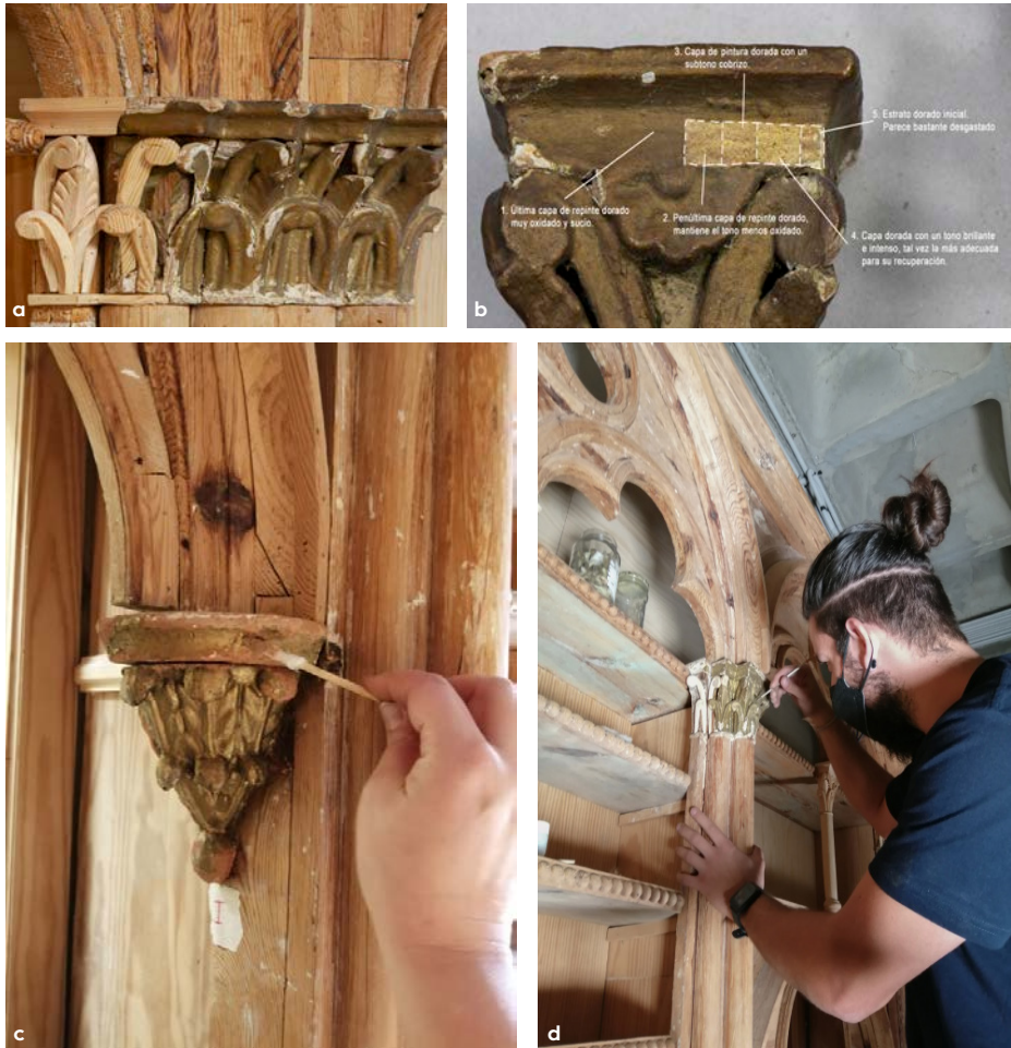
Fig. 6. Distintas fases en el proceso de restauración de los capiteles dorados. Reposición de elementos perdidos (a), estudio de las distintas capas de policromado (b), limpieza (c) y estucado (d).
