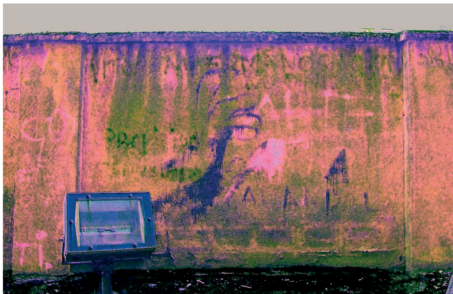
Fot. 43. Pintadas del tramo 13 de la tapia. Fotografía (tratada) del autor, 2025
